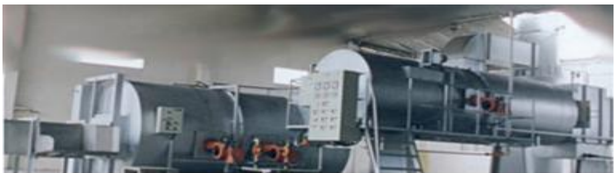
Usina de Incineração – RSSS capacidade 150Kg/h
